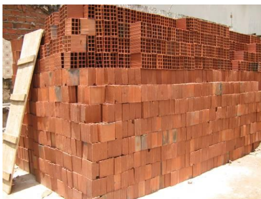
Figura 4 – Tijolos expostos ao sol (obra 1)
